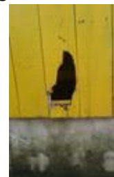
Löcher in der Wand müssen repariert werden
