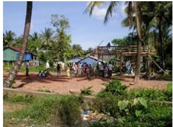
Der Rohbau der Bildungshütte. An den Wochenenden helfen viele der Englischschüler, Juli 2008
